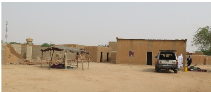
vue sur l'internat, sa cour et le pan de mur effondré à gauche.
